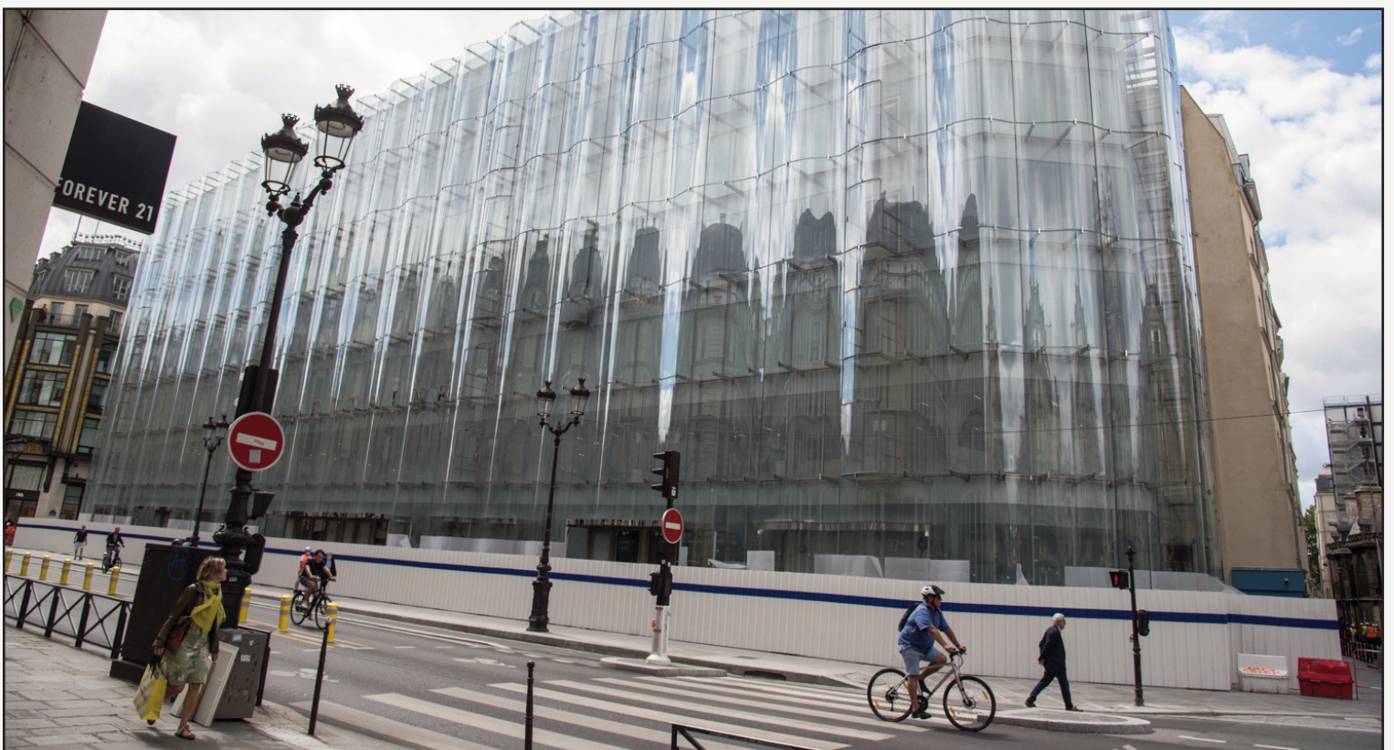
Crèche de La Samaritaine - Paris - Architecte SANAA 70 portes KID 180 vitrées classées E30 et Ei30 en hauteur 2.50 m
